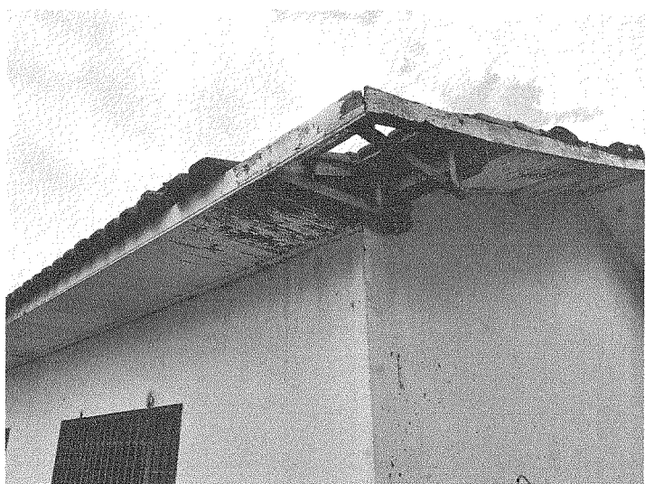
Foto 15 – Vista Problema de telhado.
